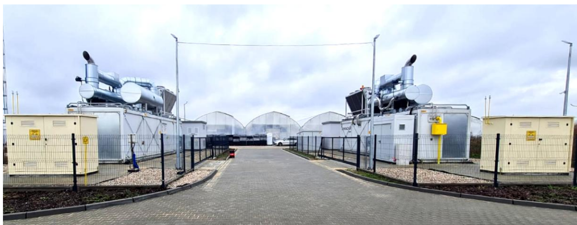
Instalacja kogeneracji 2 x 1MWe
